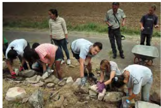
Abb. 2: World Heritage Volunteers beim Erlernen der alten Technik zum Bau von Trockenmauern, 2016 in Rüdesheim/Rhein
